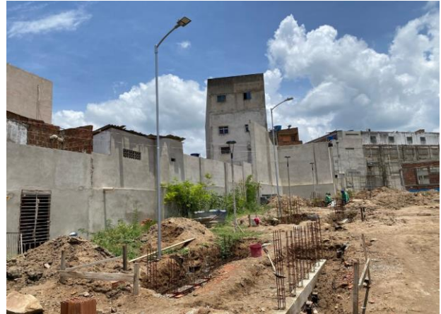
FOTO -2 INFRAESTRUTURA GERAL - Instalações elétrica
