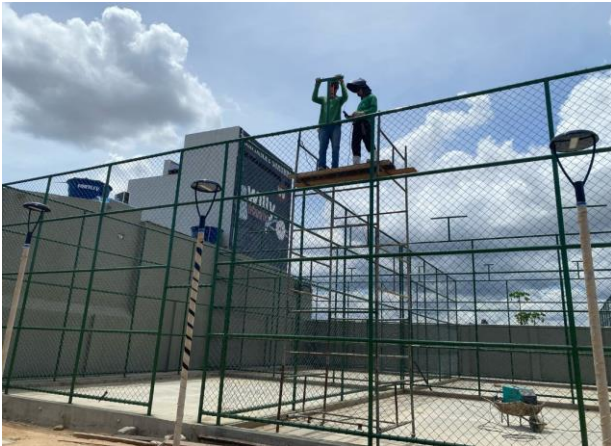
FOTO - 21 Instalações elétrica - (Futmesa, Society, Poliesportiva e Areia)
