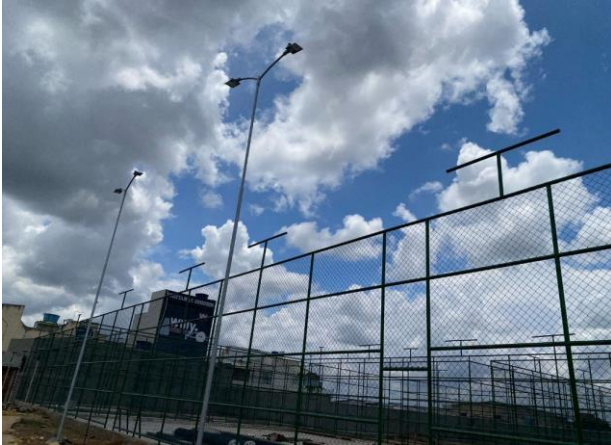
FOTO -1 INFRAESTRUTURA GERAL - Instalações elétrica
