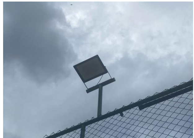
FOTO - 22 Instalações elétrica - (Futmesa, Society, Poliesportiva e Areia)
