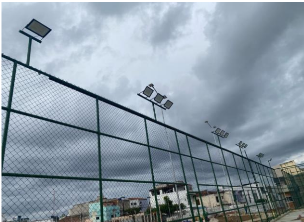
FOTO - 23 Instalações elétrica - (Futmesa, Society, Poliesportiva e Areia)
