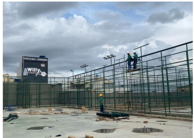
FOTO - 24 Instalações elétrica - (Futmesa, Society, Poliesportiva e Areia)
