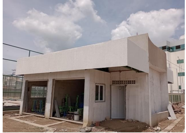
FOTO - 14 Banheiro de esportes
