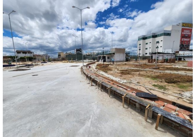
FOTO -2 INFRAESTRUTURA GERAL - Instalações elétrica
