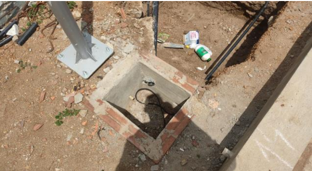
FOTO -3 INFRAESTRUTURA GERAL - Instalações elétrica
