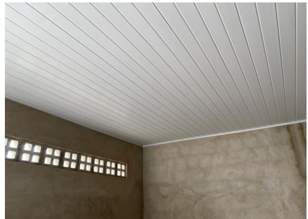
FOTO - 16 Banheiros da área de Piquenique - Forro de PVC
