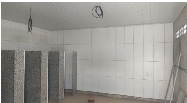
FOTO - 17 Banheiros da área de Piquenique - Forro de PVC
