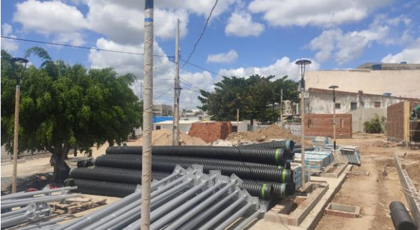
FOTO - 19 Área de Piquenique - Postes e luminárias
