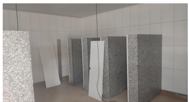
FOTO - 18 Banheiros da área de Piquenique - Forro de PVC
