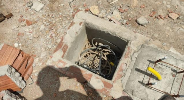
FOTO -1 INFRAESTRUTURA GERAL - Instalações elétrica
