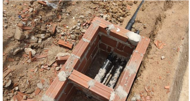
FOTO -2 INFRAESTRUTURA GERAL - Instalações elétrica
