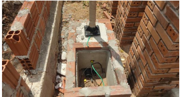
FOTO -4 INFRAESTRUTURA GERAL - Instalações elétrica
