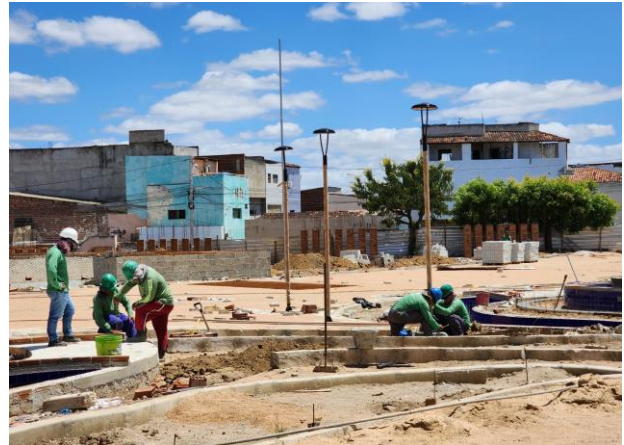
FOTO - 38 Área de Eventos (postes/luminárias decorativa)
