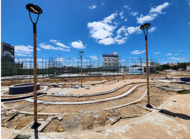
FOTO - 37 Área de Eventos (postes/luminárias decorativa)
