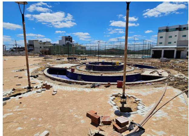
FOTO - 40 Área de Eventos (postes/luminárias decorativa)
