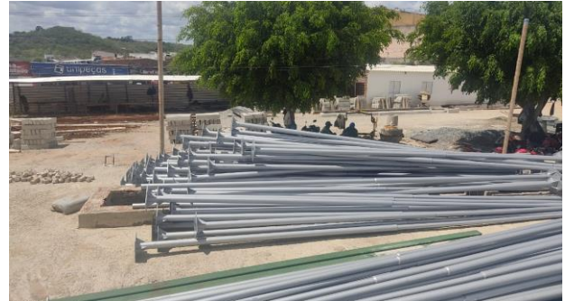
FOTO - 20 Área de Piquenique - Postes e luminárias
