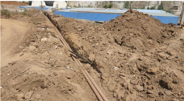
FOTO - 15 Infraestrutura Geral - Hidráulica
