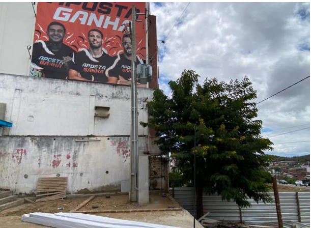
FOTO -5 Subestação aérea voltada p/ Travessa 13 de Maio
