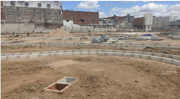
FOTO - 9 Infraestrutura Geral - Caixa de elétrica
