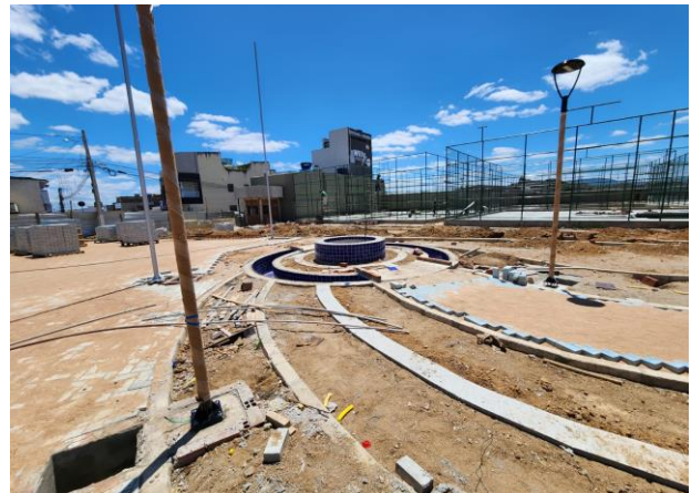
FOTO - 34 Área de Eventos (postes/luminárias decorativa)
