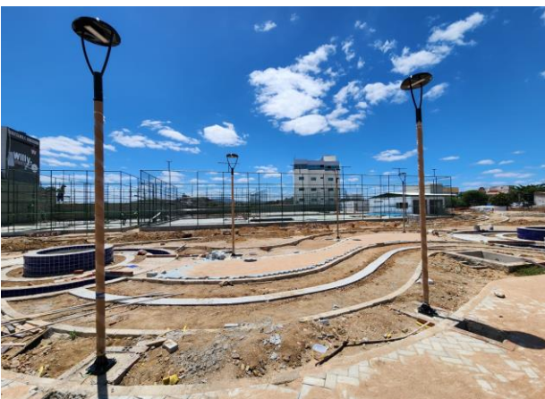
FOTO - 35 Área de Eventos (postes/luminárias decorativa)
