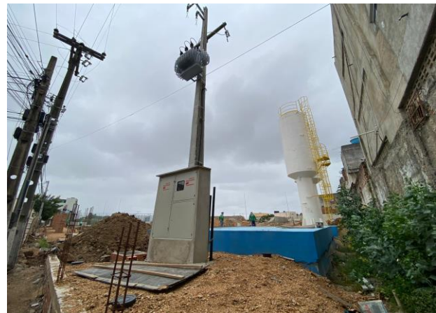
FOTO -4 Subestação aérea voltada p/ Rua Jerônimo Celestino
