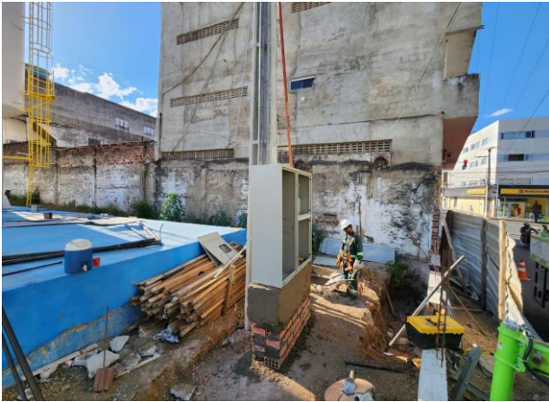
FOTO -1 Subestação aérea voltada p/ Rua Jerônimo Celestino
