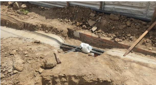
FOTO - 11 Infraestrutura Geral - Eletrodutos
