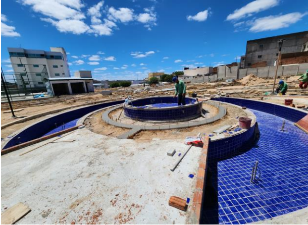
FOTO - 37 Área de Eventos (postes/luminárias decorativa)
