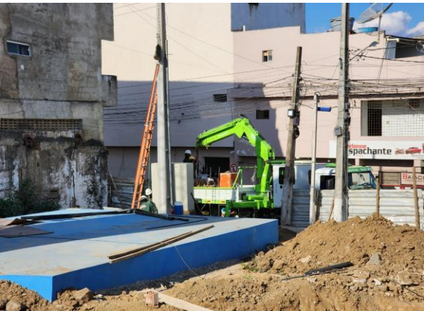
FOTO -3 Subestação aérea voltada p/ Rua Jerônimo Celestino
