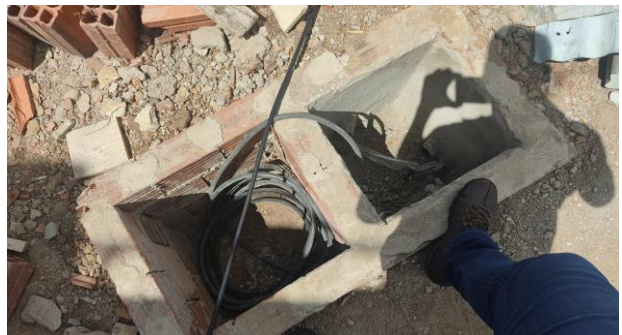
FOTO - 12 Infraestrutura Geral - Cabos
