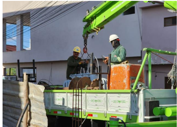
FOTO -2 Subestação aérea voltada p/ Rua Jerônimo Celestino
