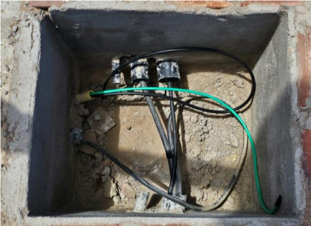
FOTO - 13 Infraestrutura Geral - Eletrodutos
