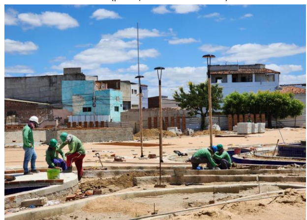
FOTO - 36 Área de Eventos (postes/luminárias decorativa)
