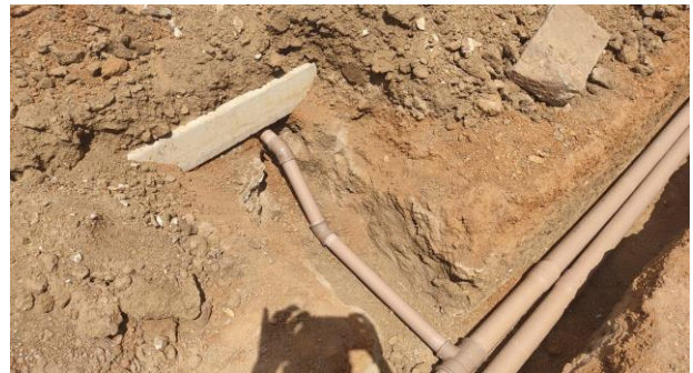
FOTO - 16 Infraestrutura Geral - Hidráulica
