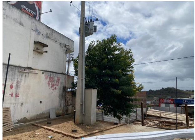
FOTO -6 Subestação aérea voltada p/ Travessa 13 de Maio
