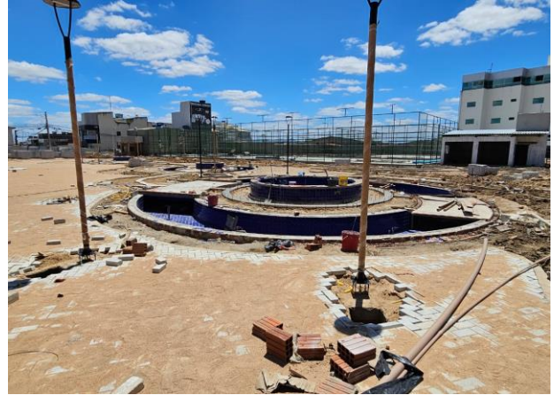
FOTO - 38 Área de Eventos (postes/luminárias decorativa)
