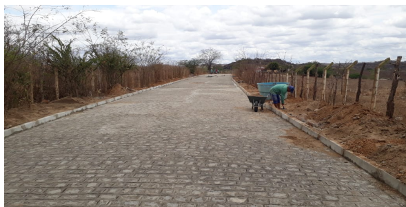
FOTO-5 (Pavimento - ITEM 2.3)
