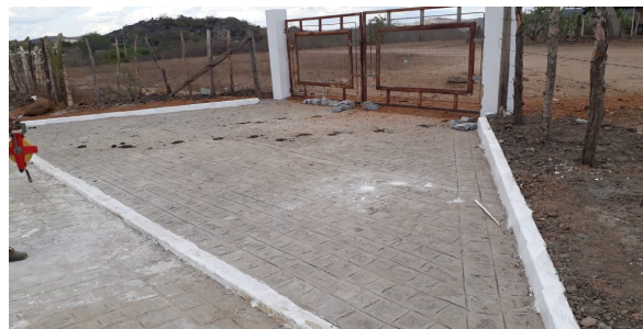
FOTO-4 (Pavimento - ITEM 2.3)
