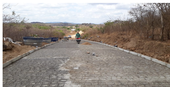
FOTO-6 (Pavimento - ITEM 2.3)
