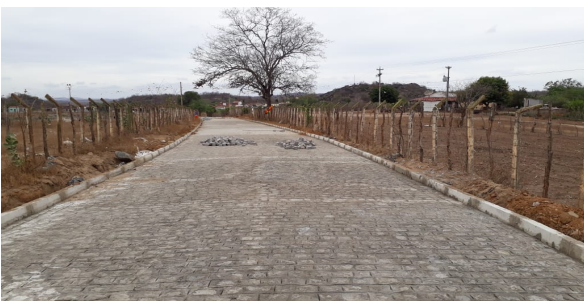
FOTO-5 (Pavimento - ITEM 2.3)
