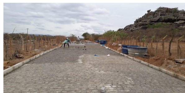
FOTO-4 (Pavimento - ITEM 2.3)
