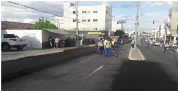
Foto-03 (Complemento da faixa de rolamento - lado esquerdo - Sentido Rua Adalgiza Moura)
