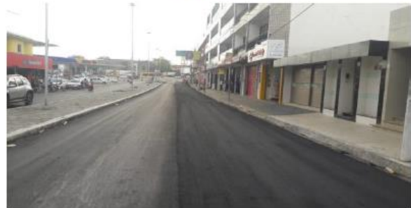
Foto-04 (Complemento da faixa de rolamento - lado esquerdo - Sentido Rua Adalgiza Moura)
