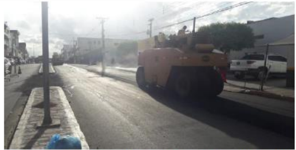
Foto-02 (Complemento da faixa de rolamento - lado esquerdo - Sentido Rua Adalgiza Moura)
