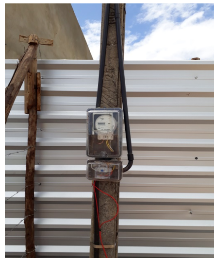
ITEM 1.7 (Inst. Elétrica)
