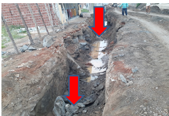
TRECHO DE ROCHAS JÁ RETIRADAS PARA ATINGIR A COTA DA ESCAVAÇÃO DE PROJETO, SERVIÇO À SER ADITADO. RUA PETRÔNIO BARBOSA
