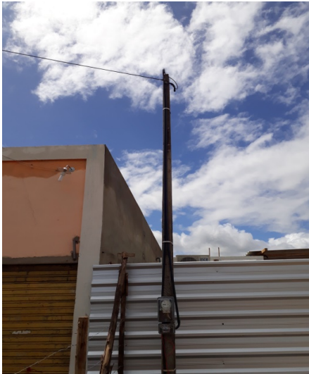
ITEM 1.7 (Inst. Elétrica)
