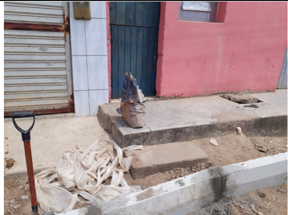
Foto-02 (RUA PROJETADA 01-Valetim-III)
