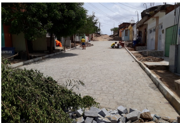
Foto-05 (RUA MANOEL JOAQUIM DE LIMA - Antão) - "Trecho-01"
