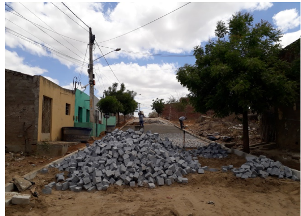
Foto-02 (RUA PROJETADA 01-Valetim-III)
