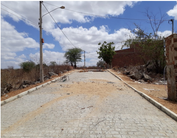
Foto-01 (RUA PROJETADA 01-Valetim-III)
