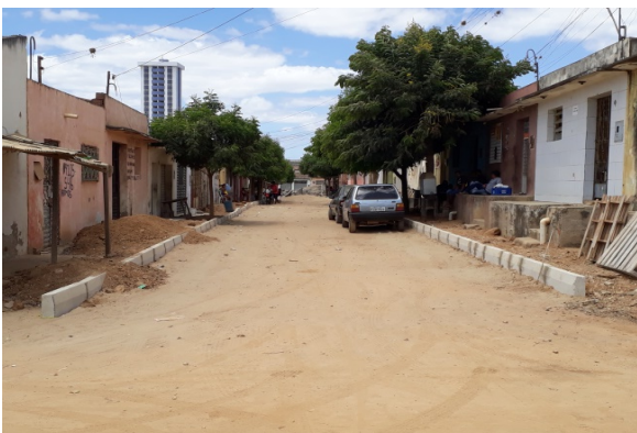
Foto-05 (RUA SEVERINO VALETIM-Valetim-II)
