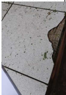
Figura 18: Exemplo de revestimento quebrado na calçada
