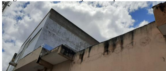
Figura 03: Trecho da laje da marquise com danos
